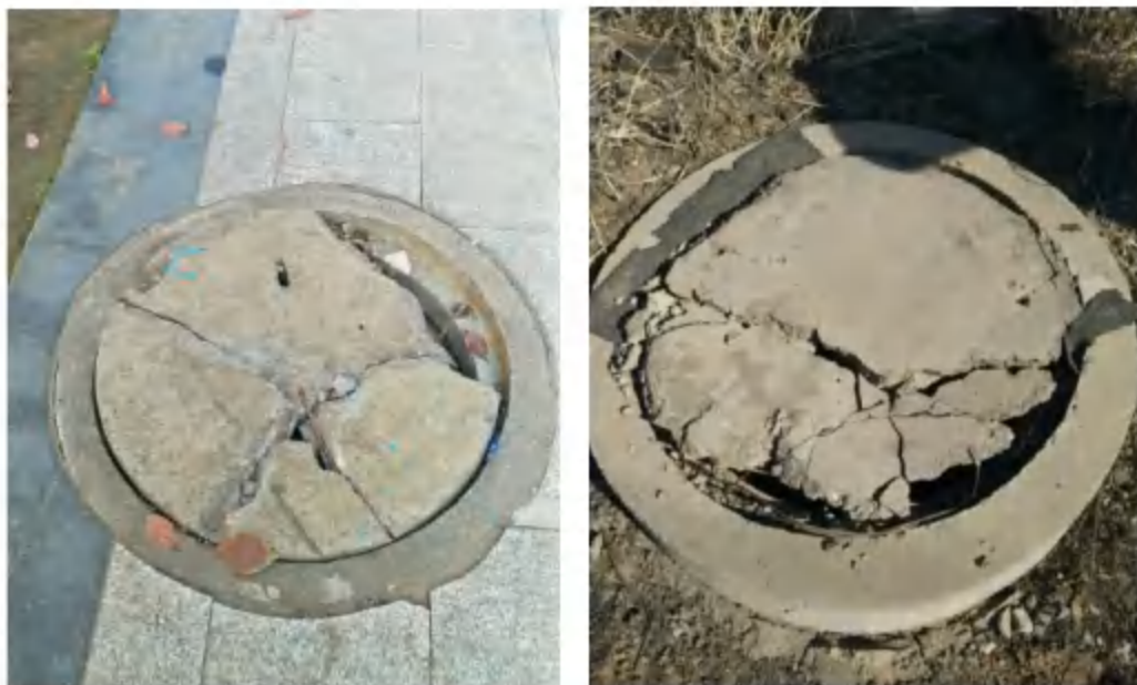
图 3.1.3-1 一期管线井盖破损
